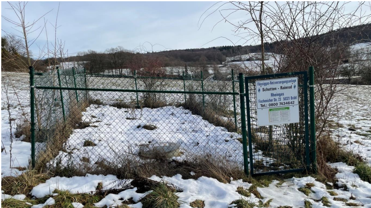
Foto: Flüssiggas-Netzversorgungsanlage mit Blick in Richtung Osten des Plangebietes; Quelle: Ingenieurbüro Zillinger, Januar 2021
