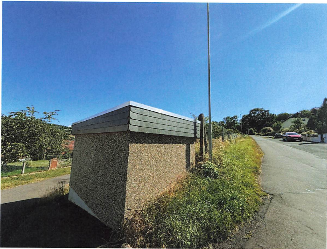
Foto 6: Blick aus Richtung Norden auf die Trafostation der OVAG
